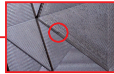
折损点 Broken point
